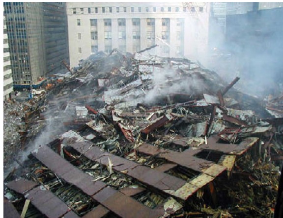
Die Stahlkonstruktion von Gebäude 7 wurde zerstückelt und in einem kompakten Trümmerhaufen abgelegt.
